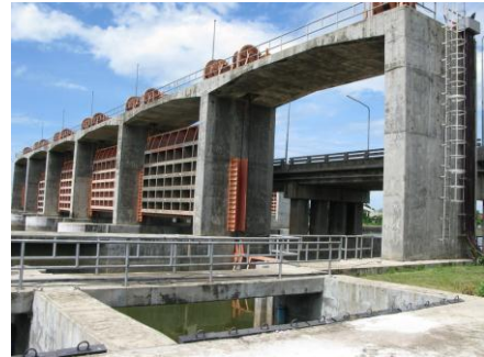
รูปที่ 1 แสดงลักษณะประตูระบายน้ำที่ดำเนินการติดตั้งระบบควบคุมการเปิด-ปิดประตูระบายน้ำแบบอัตโนมัติ
