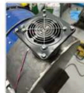
พัดลมระบายไอน้ำ
